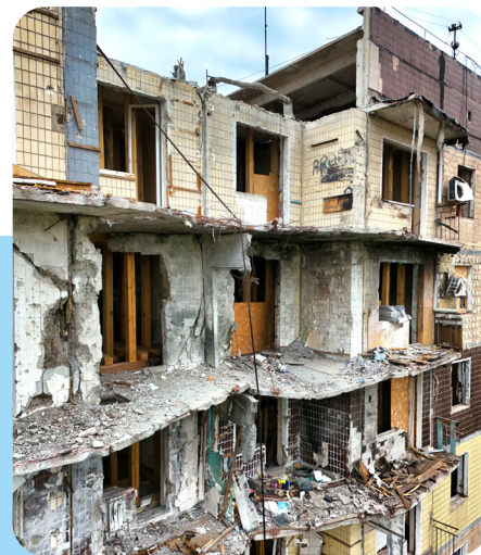
Відновлення багатоповерхового будинку у Кривому Розі після ракетного обстрілу
