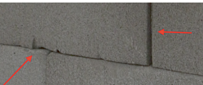
Рисунок 7: Плохо обработанные швы являются тепловыми мостами
